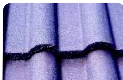
5. Aspect des tuiles après recoloration.
